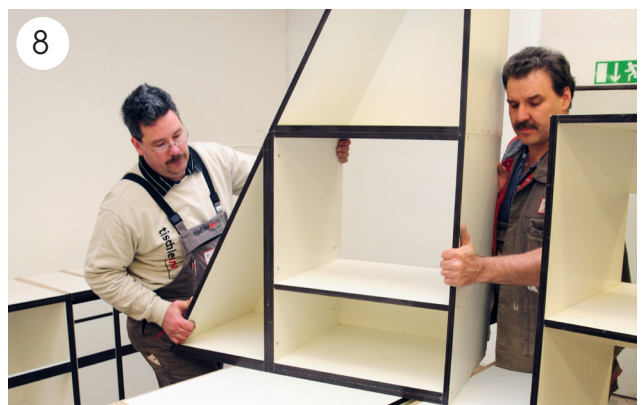
8 In der Schreinerei wird die Küche zur Kontrolle vormontiert, bevor sie beim Kunden eingebaut wird.
