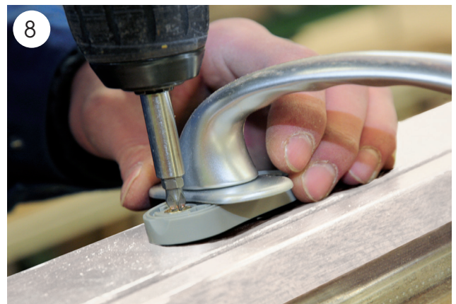
8 Zum Abschluss der Fensterproduktion in der Schreinerei werden die Scharniere und Griffe am Fenster montiert.
